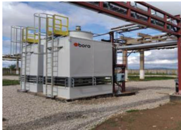
▲ Новый водоблок производительностью 35 куб. м/ч
