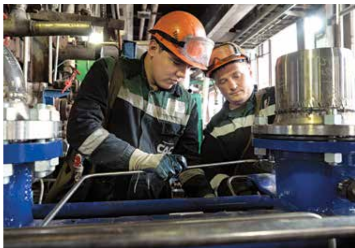
▲ На Карбамиде реализуется программа по замене центробежных насосов
