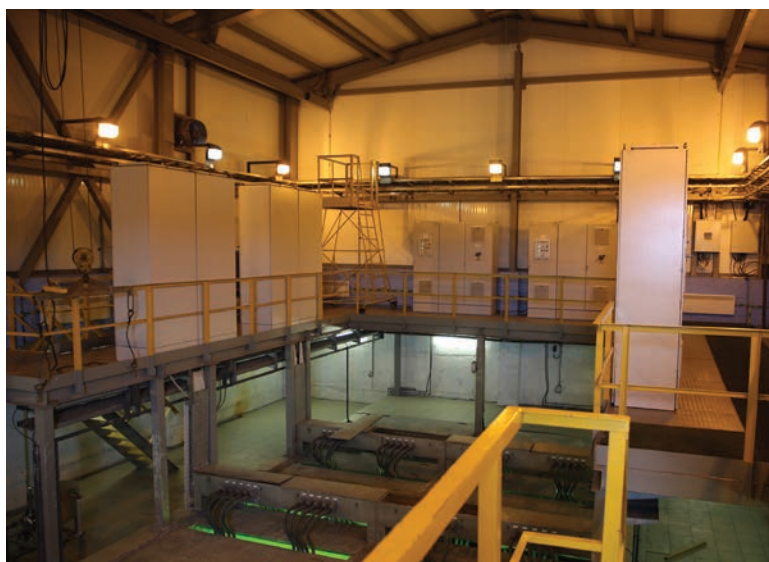
▲ Станция ультрафиолетового обеззараживания цеха НОПСВ — финальная точка многоступенчатой системы очистки сточных вод
