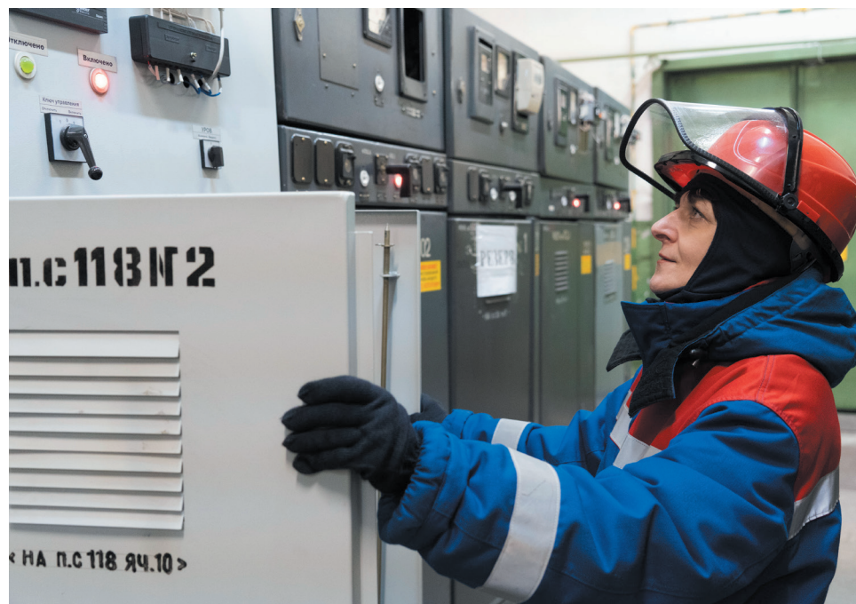
Надежда Черкасова, электромонтер, проводит осмотр оборудования электроподстанции
