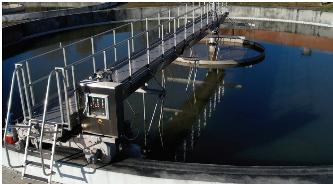
▲ На очистные сооружения «Азота» поступают сточные воды со всей левобережной части Кемерова
