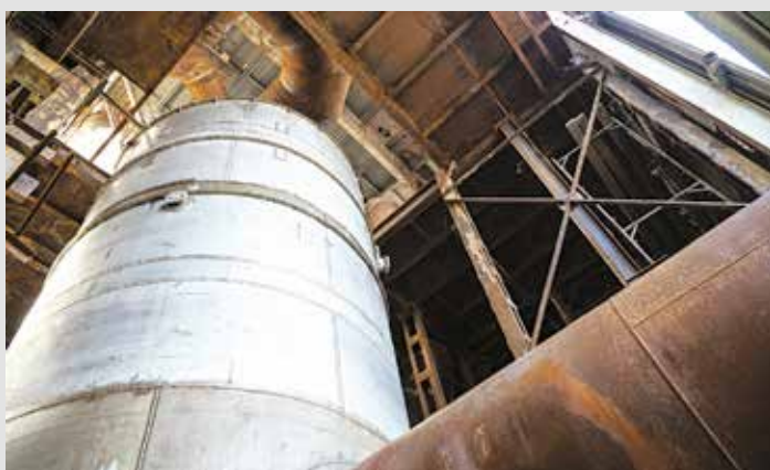
Олеумный адсорбер, изготовленный на «Химмаше»
