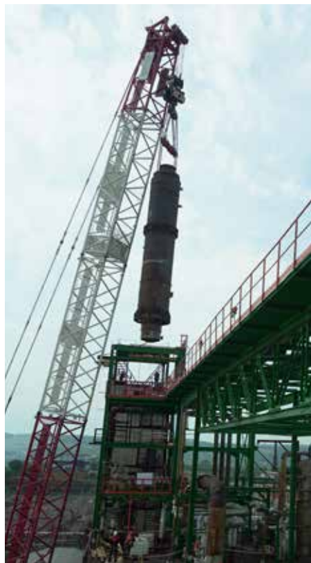
▲ Вес нового конденсатора — 160 тонн
