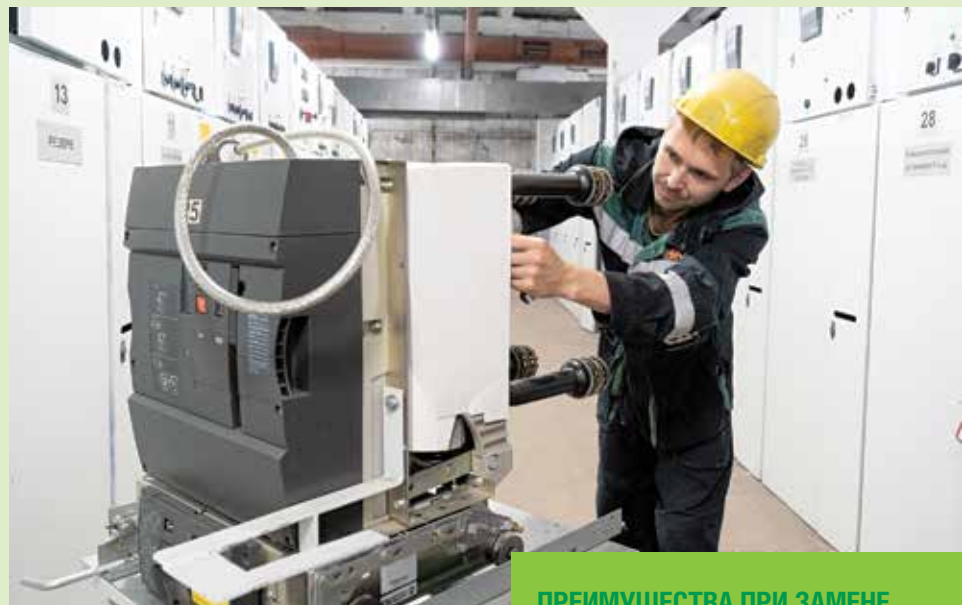
▲ Новые вакуумные выключатели в цехе Аммиак-2
