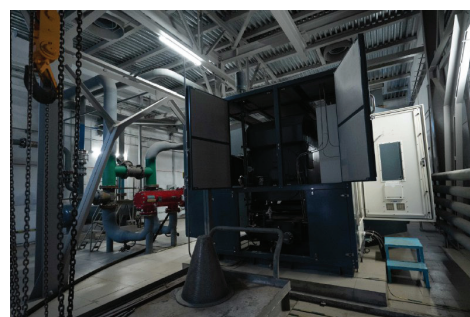
▲ Установка нового воздушного компрессора SeAH в цехе анон-2 привела к сокращению производственных потерь
