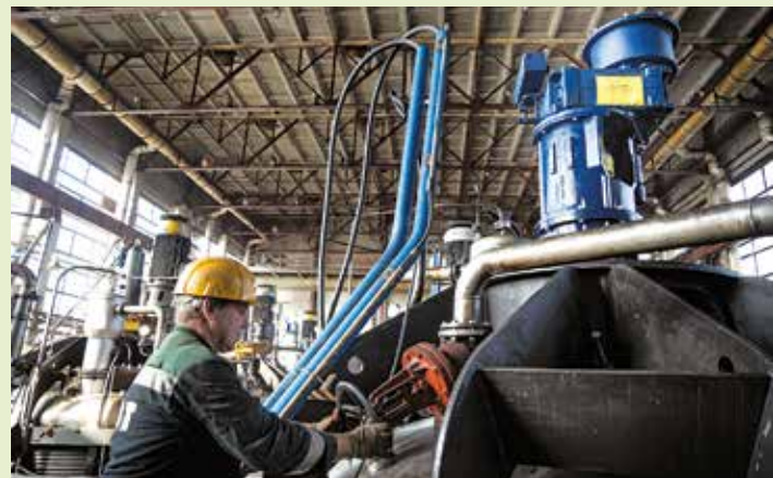
Обновленный реактор цеха ГАС: вид снаружи
